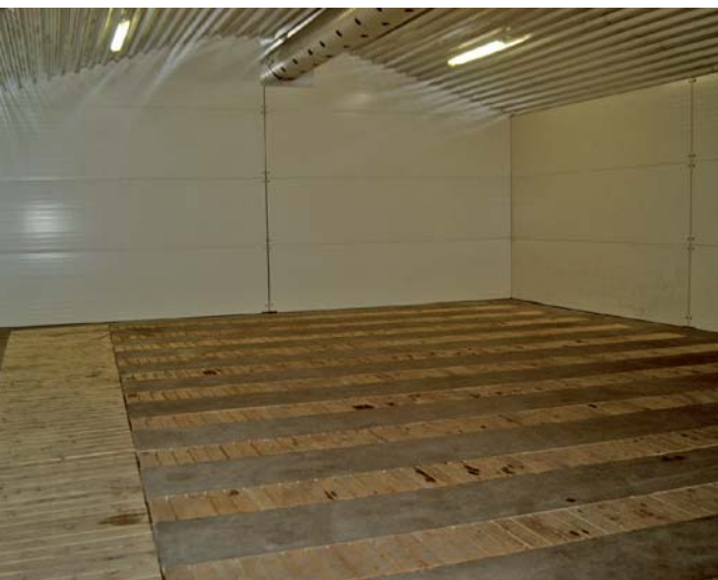
Erään lämminilmakuivurin kuivaustila. Lämpimän ilman tulokanava katossa ja poistoilmakanavat lattiassa. Kuva: VTT.
