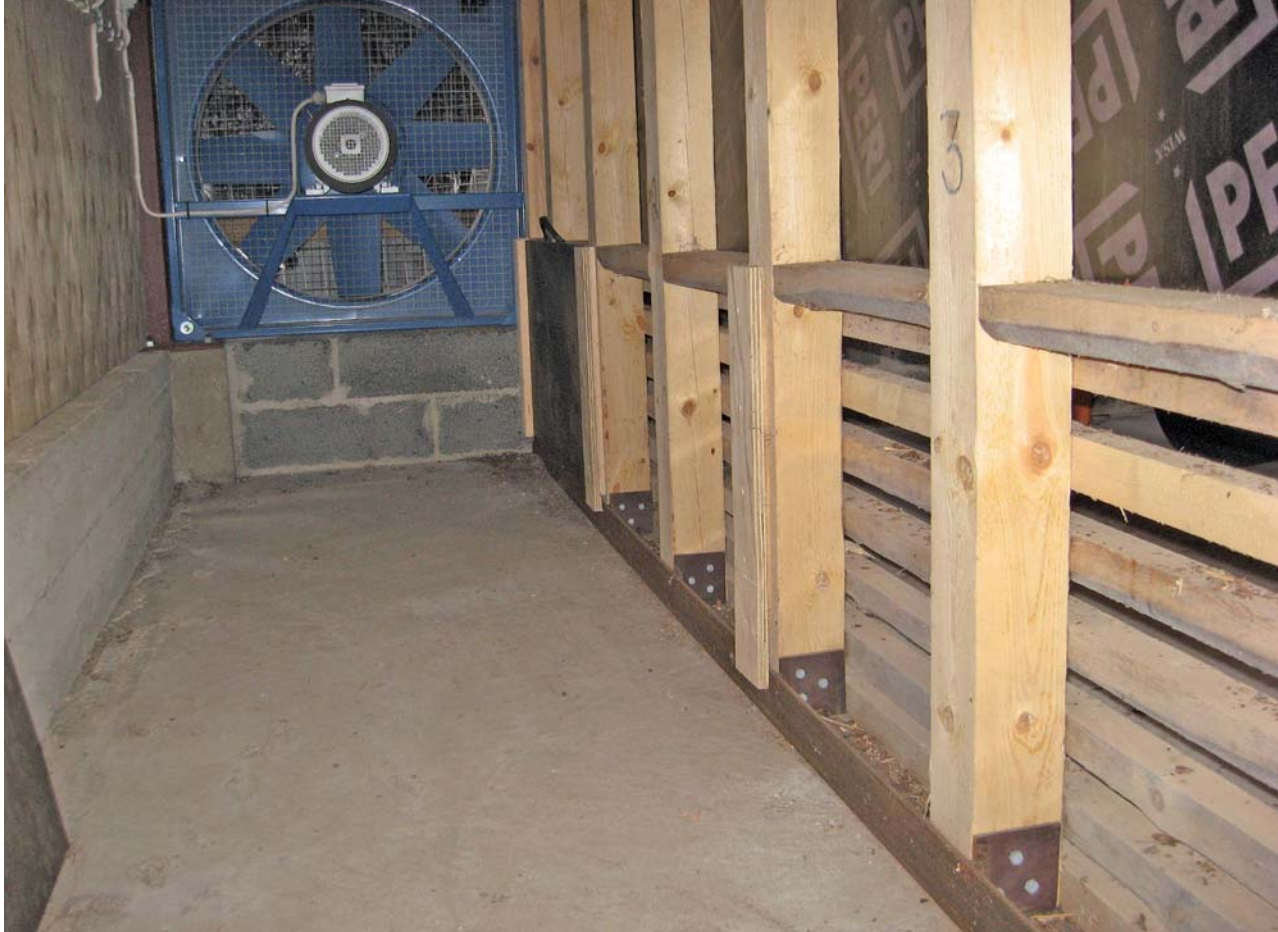
Kylmäilmakuivurin poistoilman kanava. Kuva: VTT.
